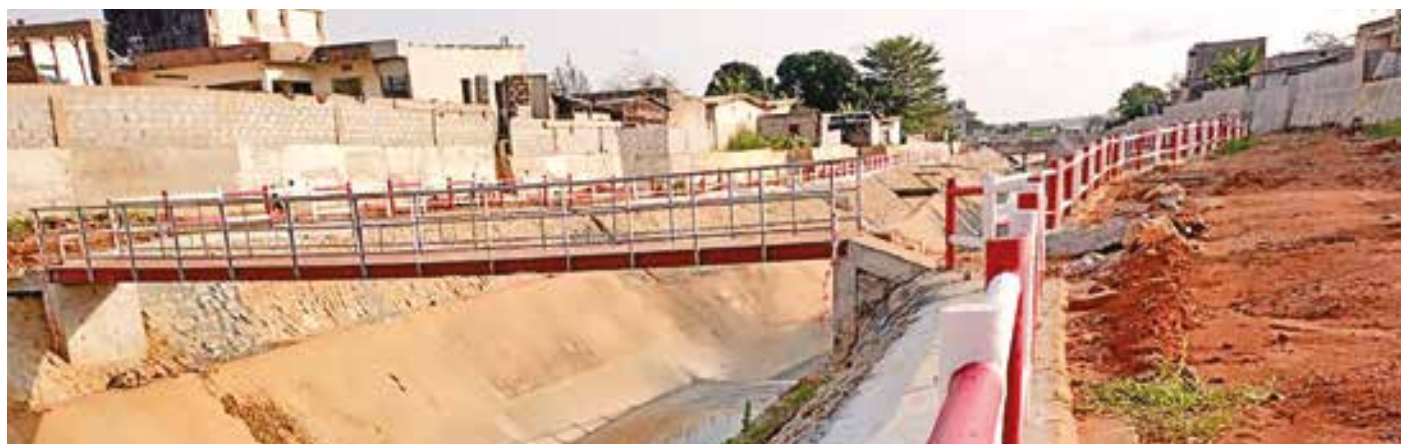
Construction du drain de Yopougon, canal d'évacuation d'eaux usées et pluviales au carrefour Kilo à Lokoua
