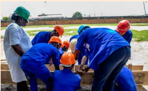
Mme Soro Alima, parallèlement, instruit les apprenants sur les techniques de réalisation du coffrage aux élèves.
