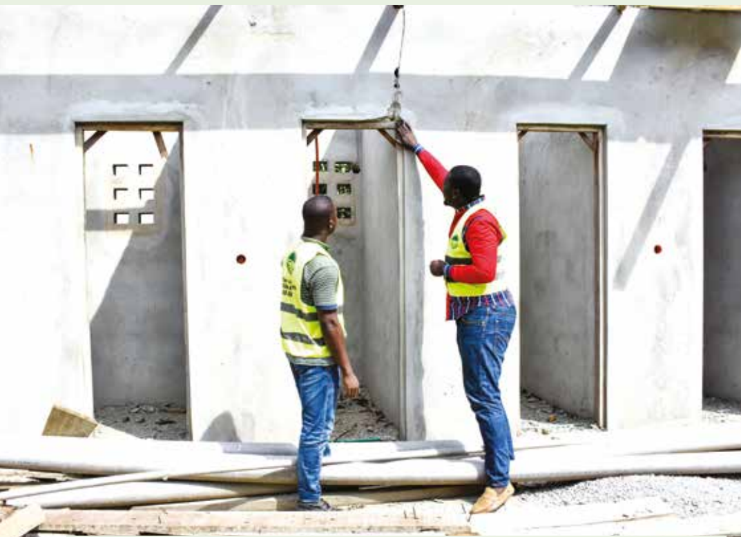
David Sanlé et son stagiaire présentent quelques pathologies de la construction de ce bâtiment.
