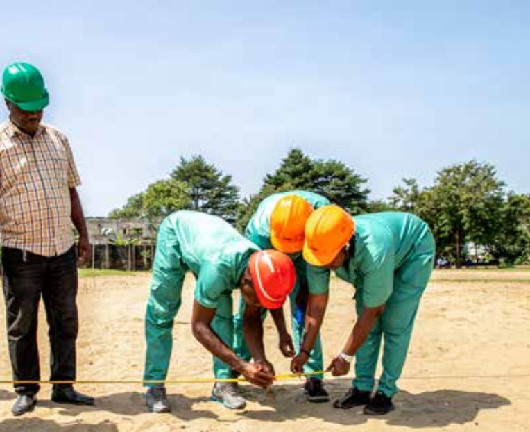
Une fois l'implantation terminée, le professeur de Génie civil, Otchoumou Vangah Léonce, peut, avec ses élèves, démarrer la construction du bâtiment.
