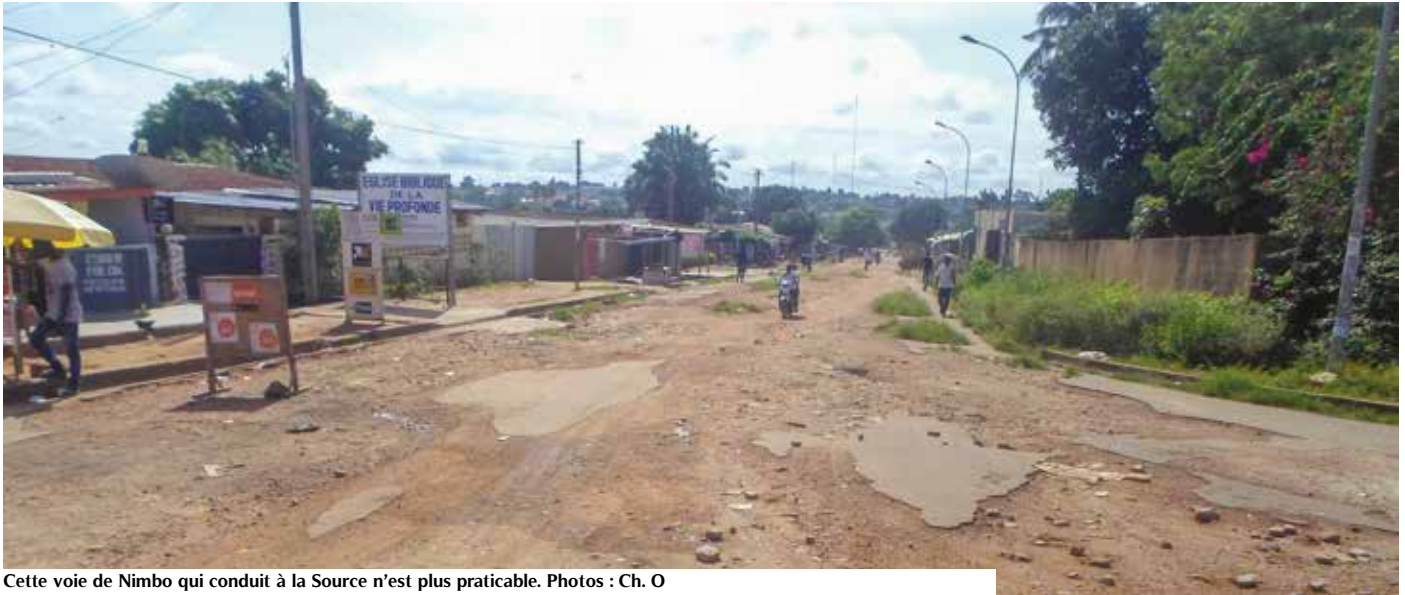
Cette voie de Nimbo qui conduit à la Source n'est plus praticable. Photos : Ch. O
