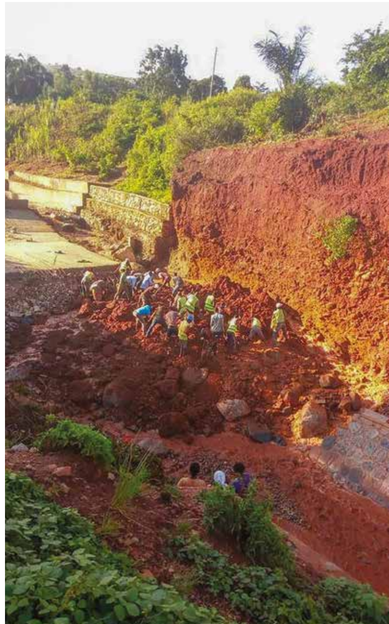
Eboulement sur un chantier
