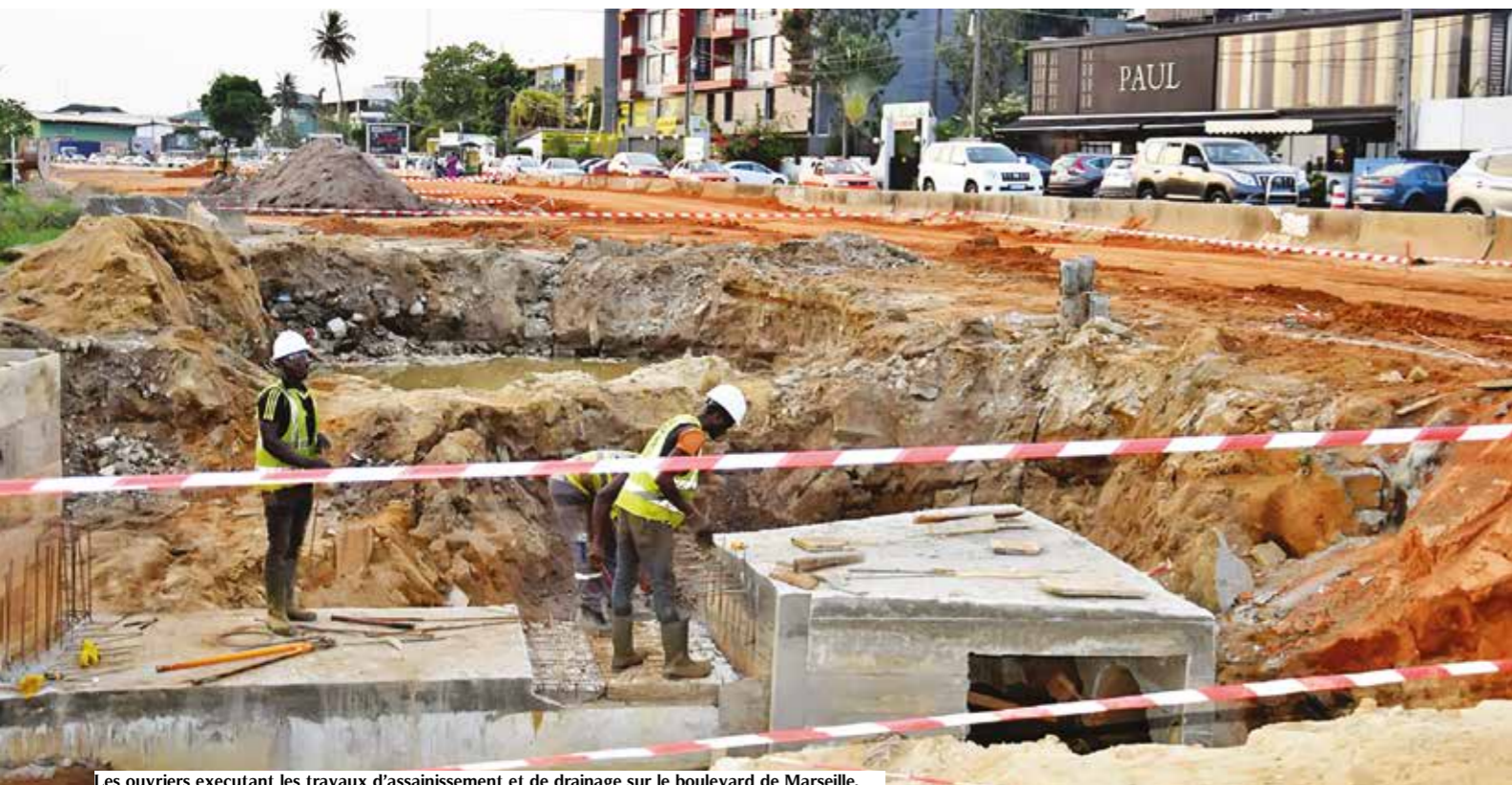
Les ouvriers exécutant les travaux d'assainissement et de drainage sur le boulevard de Marseille.
