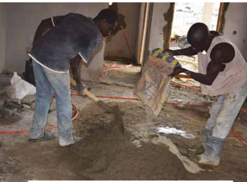
Des ouvriers mélangent le ciment au sable et à l'eau pour le crépissage
